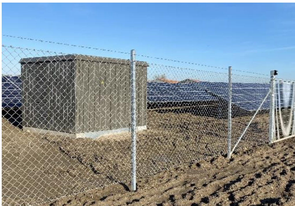
Figur 3-14. Foto eksempel på parktransformer. Kilde: Ecosolar.
